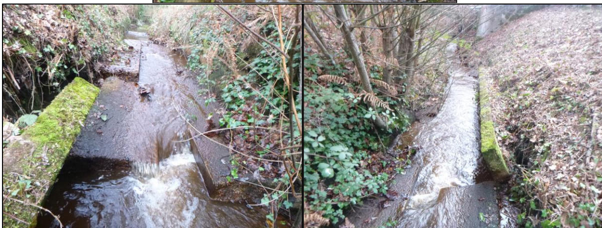
Photo 6 : Déchaussements du radier béton et chute des protections de berges sur le Bétey aval
