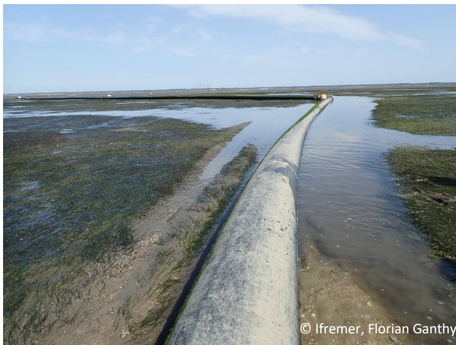
Figure 17 : Conduite de refoulement reposant sur l'herbier
