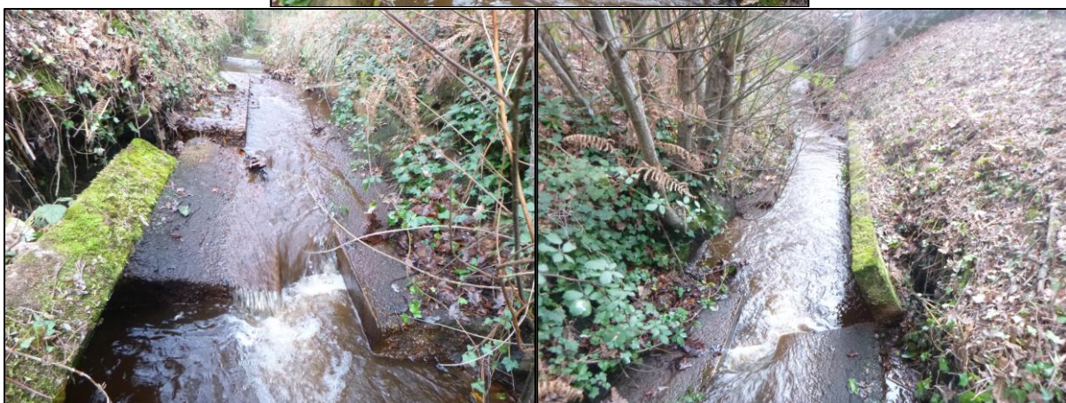
Photo 6 : Déchaussements du radier béton et chute des protections de berges sur le Bétey aval
