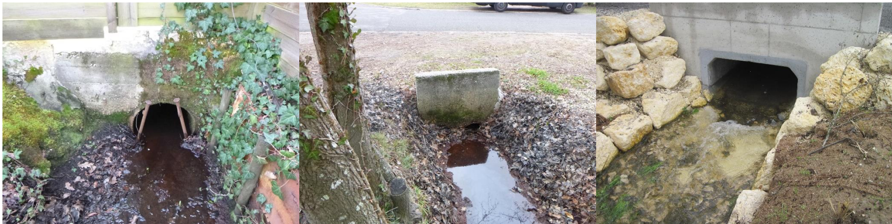
Photo 21 : Vue amont des buses à remplacer, et exemple de dalot de remplacement
