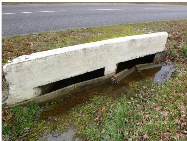
Photo 20 : Batardeau en bois à supprimer
