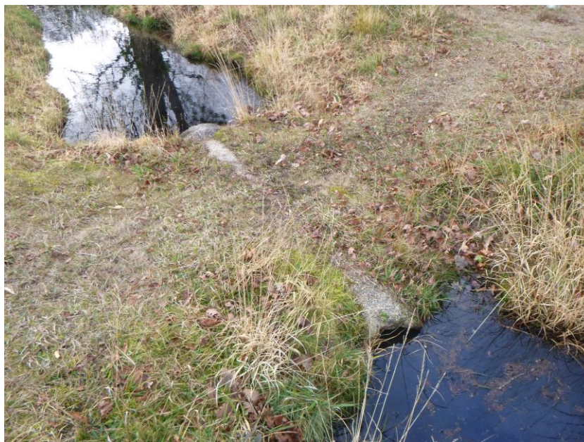
Photo 4 : Exemple d’une buse sous dimensionnée
