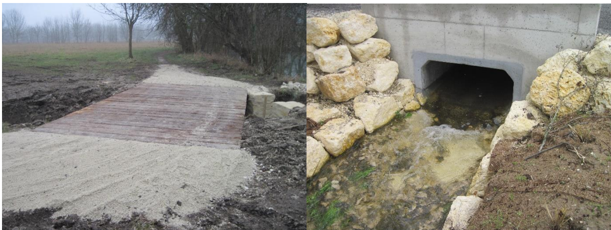
Photo 5 : Passerelle en bois et dalot à fond naturel, actions Ce03 et Ce05
