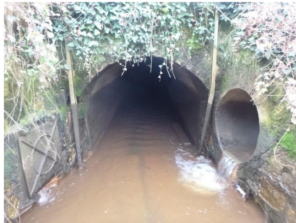
Photo 8 : Rejet industriel douteux, rejet domestique, rejets d'eau pluviale
